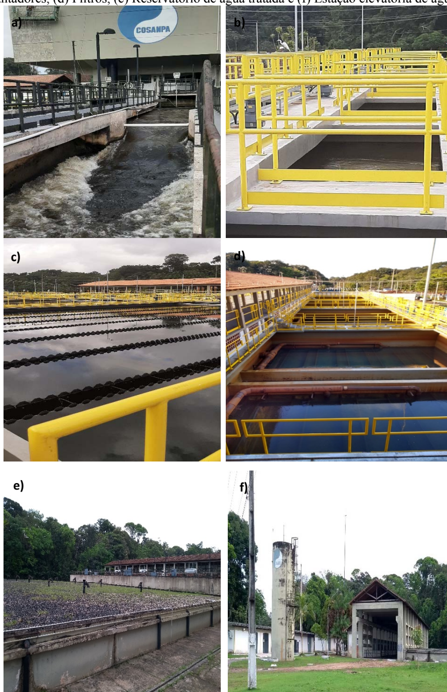
Figura 12 – Unidades de tratamento da 1ª etapa da ETA Bolonha - (a) Calha Parshall, (b) Floculadores, (c) Decantadores, (d) Filtros, (e) Reservatório de água tratada e (f) Estação elevatória de água tratada.
