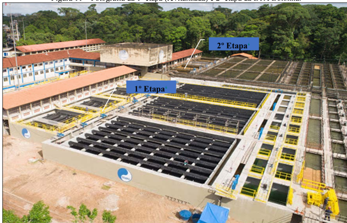
Figura 11 – Fotografia da 1ª etapa (revitalizada) e 2ª etapa da ETA Bolonha.
